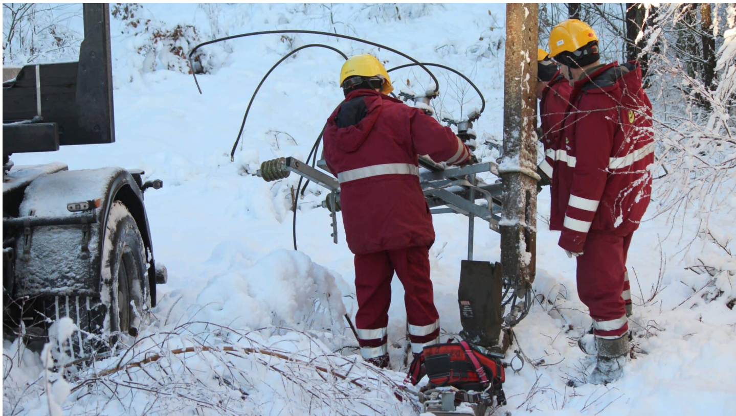
Fot. Energa-Operator S.A. Zdjęcie jest ilustracją do artykułu.
